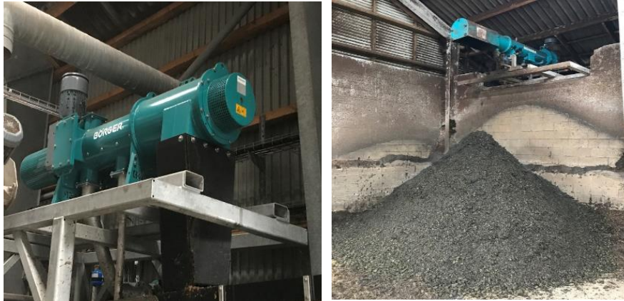
Figur 20. Börger skruepresse, der separerer ca. 75% af den afgassede gylle. Gyllefibren køres igennem biogasanlægget igen.
