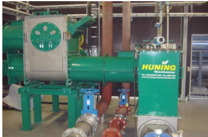
Figur 17: Hüningen hammermølle ved Thorsø Miljø- og Biogasanlæg a.m.b.a
