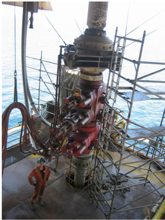
Fig. D-4 Udblæsningsforhinderer (BOP) på boreriggen ENSCO 71
