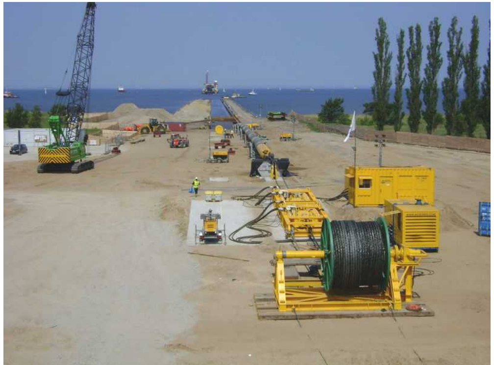
Figur 4.13. Herunder ses eksempel på hvordan en spunsgrube ved ilandføringen kan komme til at se ud samt eksempel på et trækspil (foto: Boskalis)
