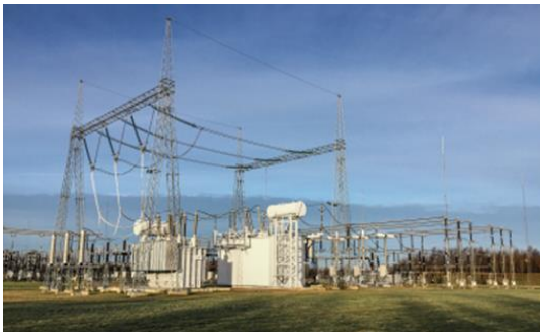
Figur 4-12 Eksempel på AIS-anlæg. Kriegers Flak Combined Grid Solution løber i land i Danmark på Stevns og møder det danske elnet i Bjæverskov, hvor Energinet har bygget en ny transformerstation til at modtage strøm fra havmøller og fra Tyskland. Foto: Energinet (Dansk Energi, 2020).
