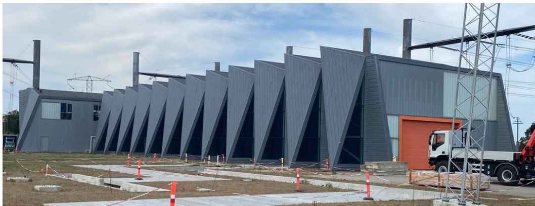
Figur 4-11 Eksempel på et GIS-anlæg. Anlægget her står ved Revsing og udgør et moderne lukket kompakt stationsanlæg.
