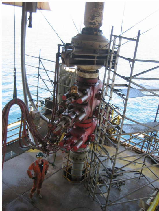
Fig. D-4 Udblæsningsforhinderer (BOP) på boreriggen ENSCO 71
