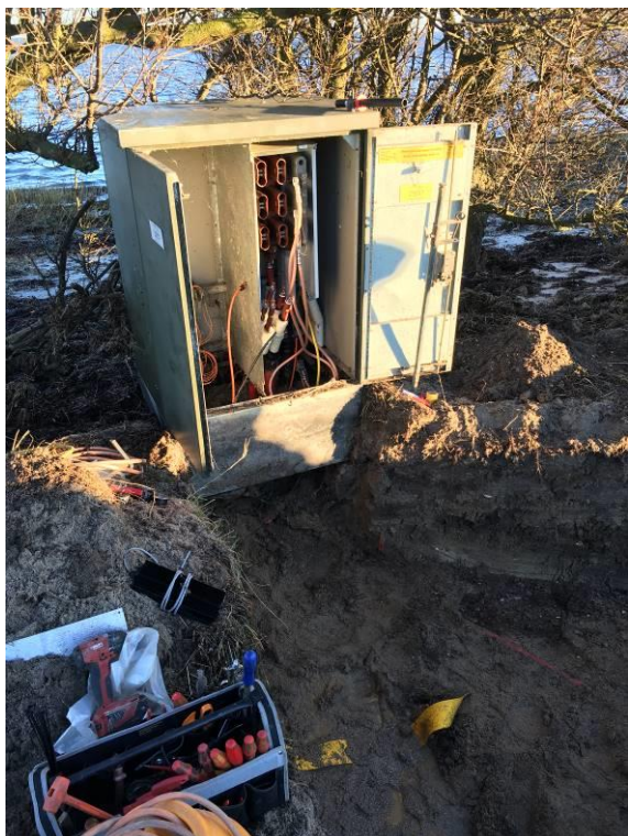
Figur 15 Elskab hvor ilandføringskablet var tilsluttet det overordnede elnet. Skabet blev også fjernet.
