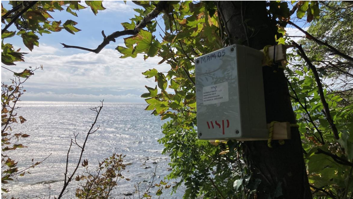
Figur 14 - Lytteboks monteret ved sydkysten af Bornholm i forbindelse med Energiø Bornholm projektet.
