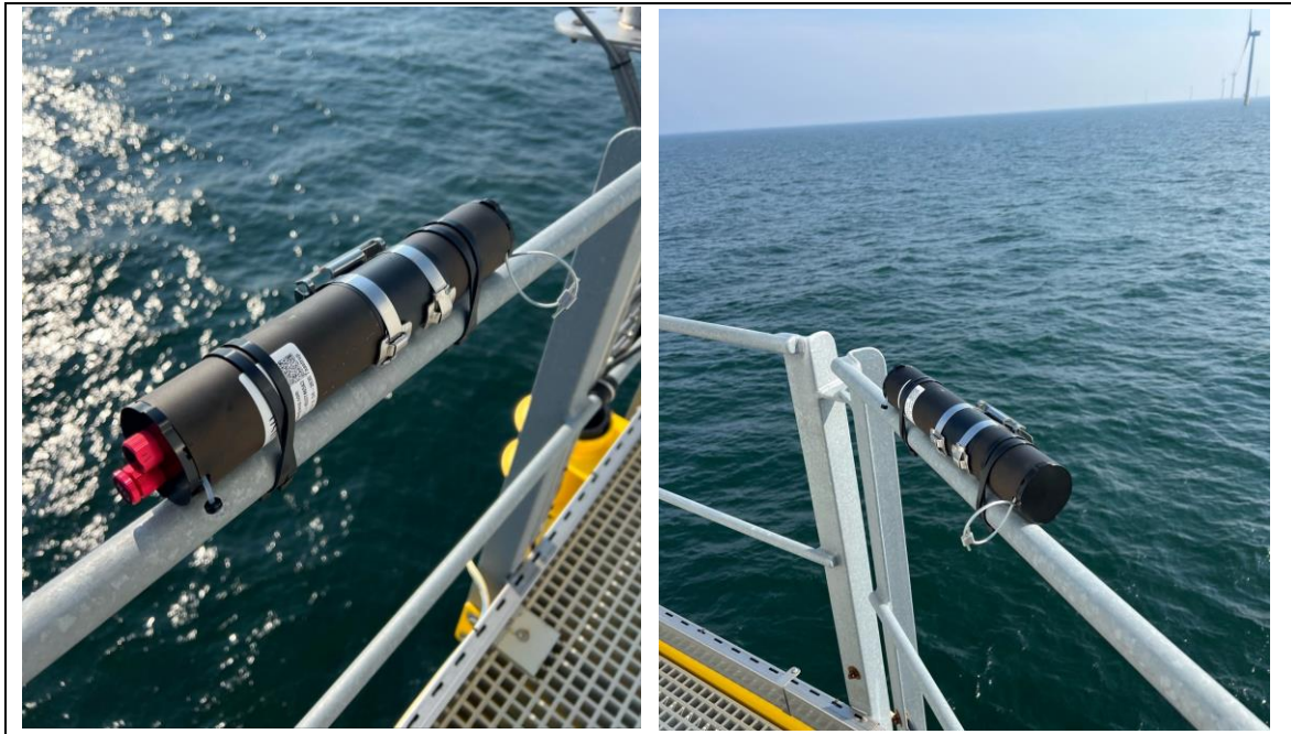
Figur 13 – Lyttebokse i form af 'SeaBat 2.0 detektorer' udviklet til offshore brug monteret på gelænderet på møllerne ca. 8 meter over havet ved Kriegers Flak i 2022.
