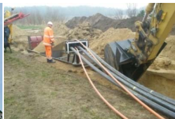
Kabelnedlægningen kan foregå med en særlig gravekasse. Kablerne vil komme til at ligge i en dybde af ca. 1,5 m.
