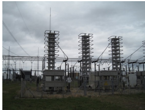
Figur 18.15. Et filterfelt er en samling af afbrydere, adskillere og måleudstyr gennem hvilke et filter tilsluttes i transformerstationen.
