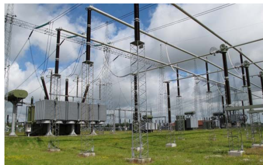
Figur 2.9. Transformerstationer består af mange stålkonstruktioner, masteanlæg og transformereenheder. Her station Endrup.
