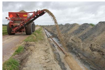
Kabellægningen afsluttes med til-dækning af kablerne med sand. Det opgravede rå- og muldjord lægges på til sidst, og arealerne retableres.
