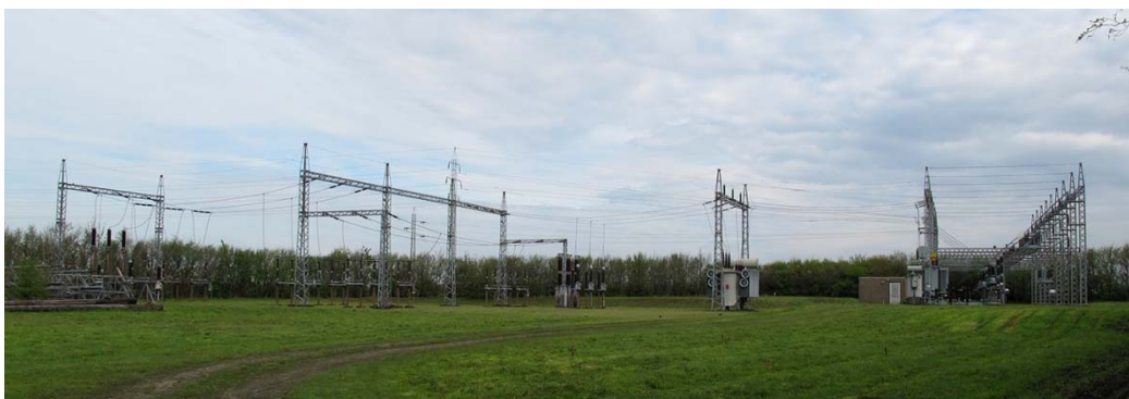
Figur 19.12. Transformerstation Holsted set fra selve stationsanlægget med den afskærmende beplantning i baggrunden.
