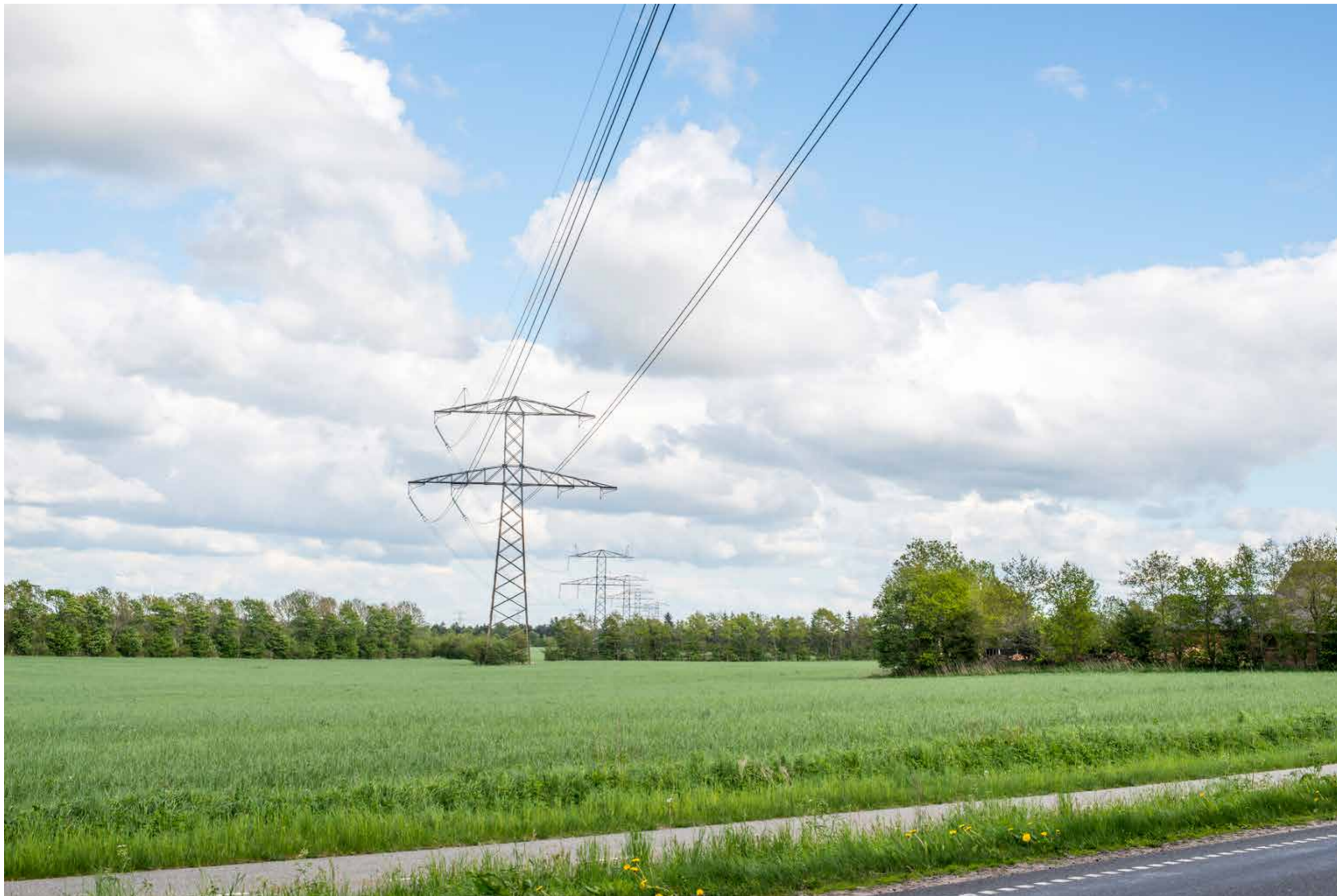
Fotostandpunkt E, højspændingsanlæg ved Læborg. Eksisterende forhold.
