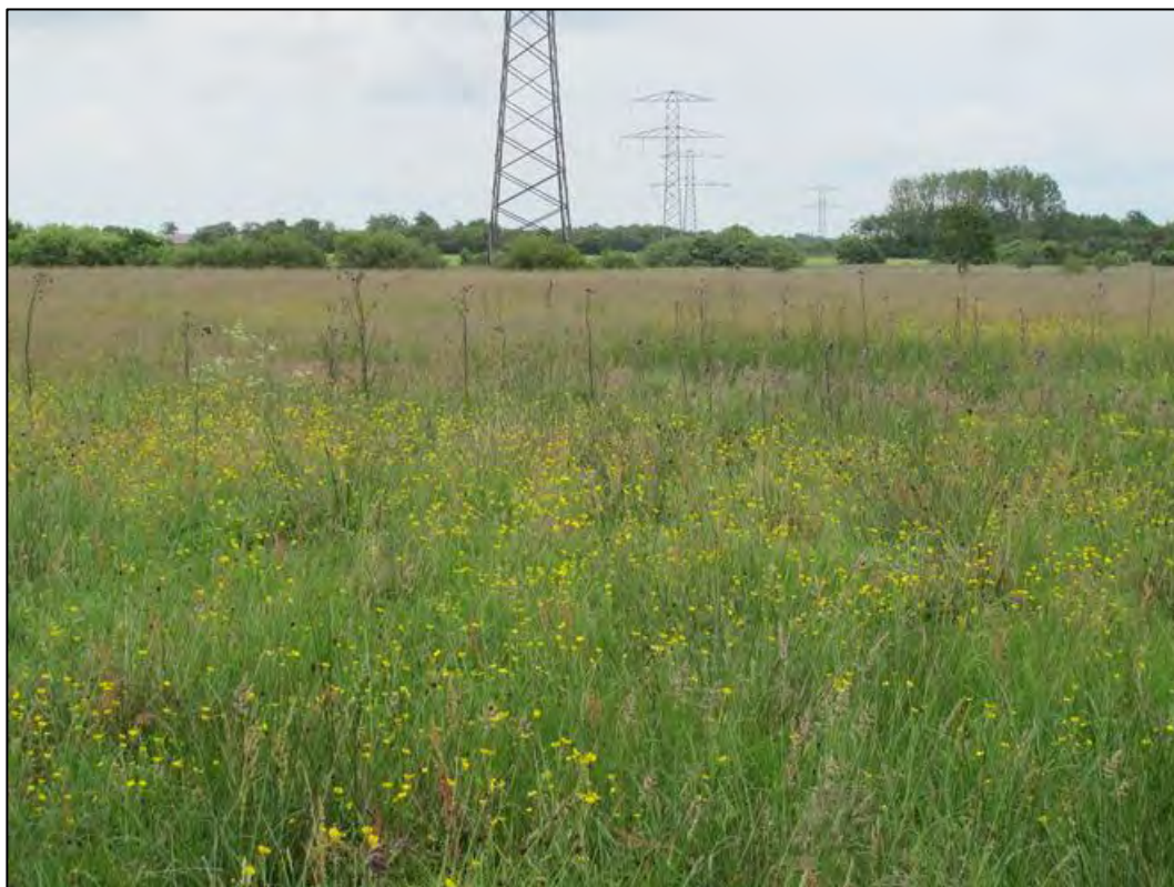
Eng 1 øst for transformerstation Endrup er af moderat naturkvalitet og udnyttes ikke aktuelt.
