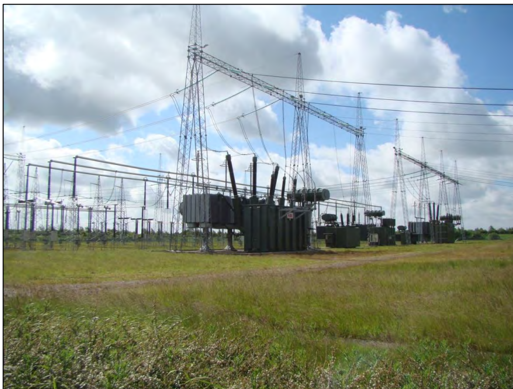
De tekniske anlæg ved transformerstation Endrup.
