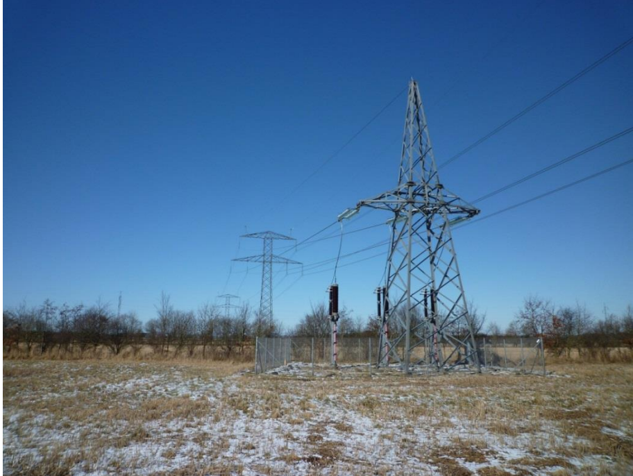
Figur 6.3. Kabelovergangsstation nord for Holsted som demonteres, Foto Energinet.dk.
