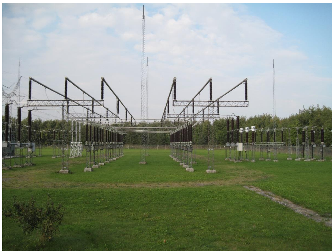
Figur 2-10. Udsnit af et åbent stationsanlæg af samme type som den nye station Tolstrup Gårde. I forgrunden ses selve højspændingsanlægget og i baggrunden lynfangsmaster.
