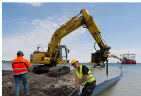
Etablering af transformerplatforme og søkabler sikrer transport af den producerede strøm til det eksisterende højspændingsnet på land (foto: Energinet.dk).
