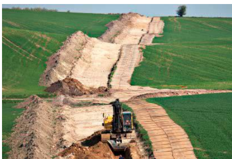
Der etableres kabelanlæg på land, som transporterer strømmen fra det sted på kysten, hvor søkabler føres i land, og videre til stationerne på land, hvor strømmen kobles til det overordnede højspændingsnet (foto: Energinet.dk).
