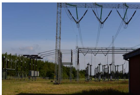
Som en del af landanlæggene skal der etableres én ny højspændingsstation. Derudover skal tre eksisterende stationer udbygges, for at strømmen kan nå ud til forbrugerne (foto: Energinet.dk).
