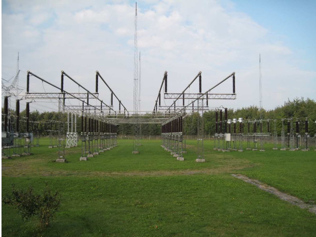
FIGUR 2-9 UDSNIT AF ET ÅBENT STATIONSANLÆG AF SAMME TYPE SOM DEN NYE STATION TOLSTRUP GÅRDE. I FORGRUNDEN SES SELVE HØJSPÆNDINGSANLÆGGET OG I BAGGRUNDEN LYNFANGSMASTER.
