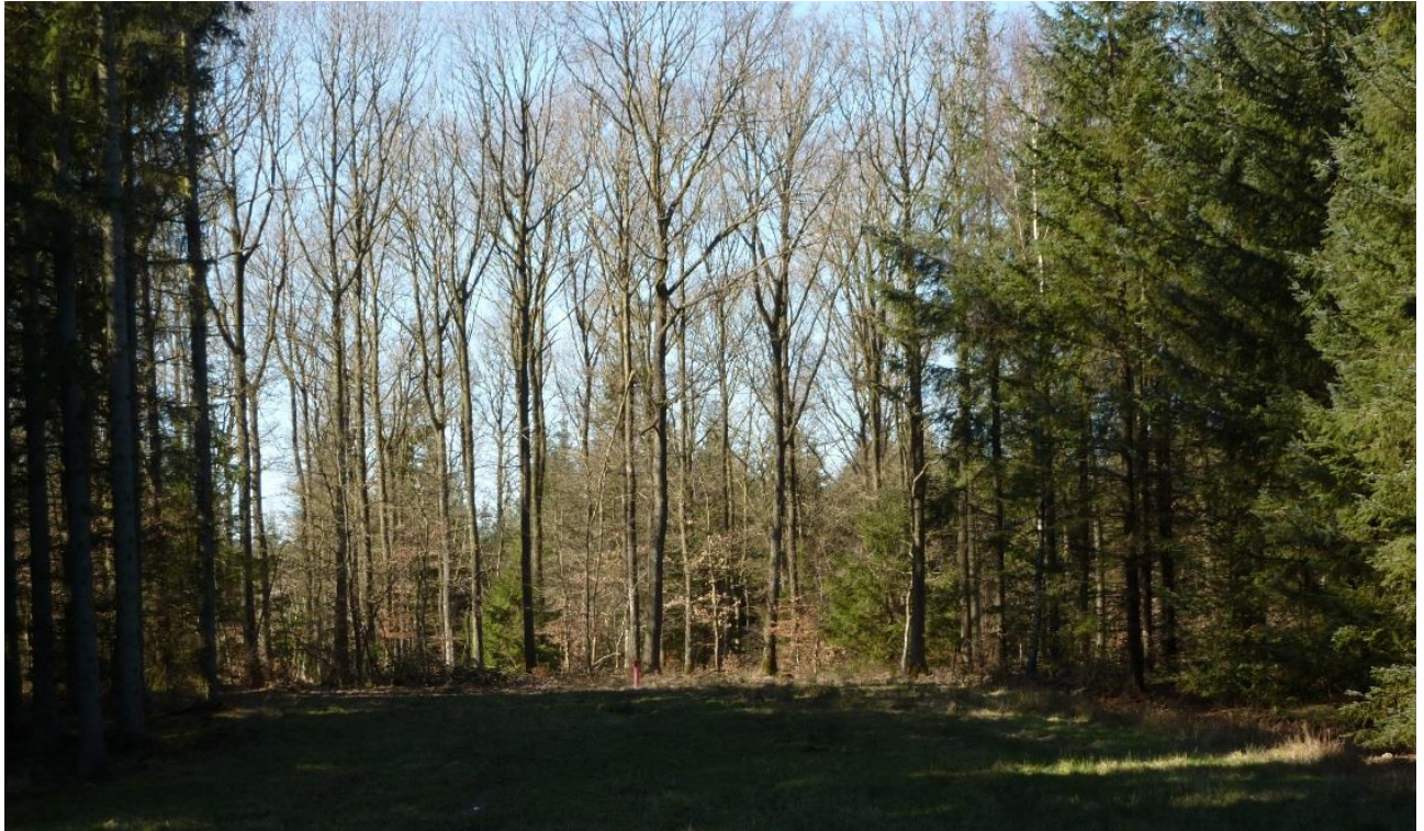
Figur 3-2 Eksempel på kabellægning i skovområde, hvor kablet er nedgravet i nåleskoven og underboret løvtræerne. For enden af det ca. 20 m brede, åbne område, kan en rød markeringspæl anses. Eksemplet er fra Løvenholm Skov på Djursland.
