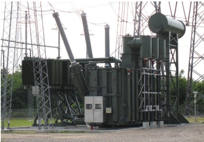
Figur 3.7 Transformere. En transformere forbinder den elektriske spænding mellem de forskellige spændingsniveauer i elnettet.
