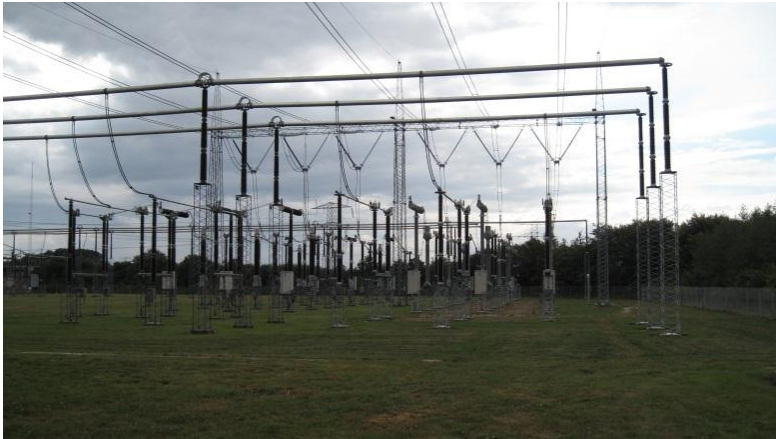
Figur 3.6 Linjefelt. Et linjefelt er en samling af afbrydere, adskillere og måleudstyr gennem hvilke en luftledning eller en kabelforbindelse tilsluttes i transformerstationen
