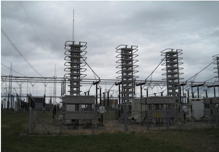
Figur 3.4 Filterfelt. Et filterfelt er en samling af afbrydere, adskillere og måleudstyr gennem hvilke et filter tilsluttes i transformestationen.
