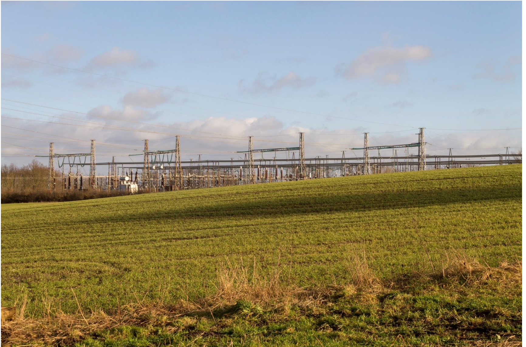
Figur 1-38 Fotopunkt D2, visualisering. Station Hovegård set fra vest. Udbygningen kan ses mellem første og anden mast fra højre, hvor der er tilføjet nogle elementer. Udbygningen ændrer ikke ved anlæggets samlede udtryk og oplevelsen af landskabet.
