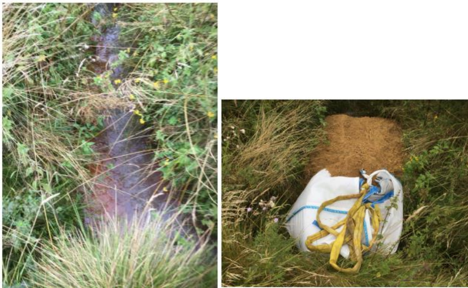
Figur 16-4 I forbindelse med Energinets projekt Horns Rev 3, hvor et kabelanlæg blev nedgravet i 2015, skete der et udslip ved en bæk. Her blev der anvendt bigbags med sand til inddæmning.
