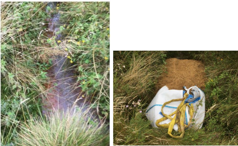
Figur 5-16 I forbindelse med Energinets projekt, Horns Rev 3, hvor et kabelanlæg blev nedgravet i 2015, skete der et blow-out ved en bæk. Her blev der anvendt bigbags med sand til inddæmning.
