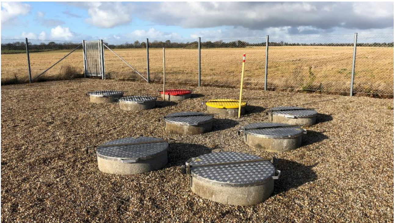
Figur 1-1 Øverst til venstre: Et eksempel på en MR-station. Øverst til højre: En kompressor på en MR-station. Nederst: Et eksempel på en LV-station. Beplantningen uden for hegnet er endnu ikke vokset op.
