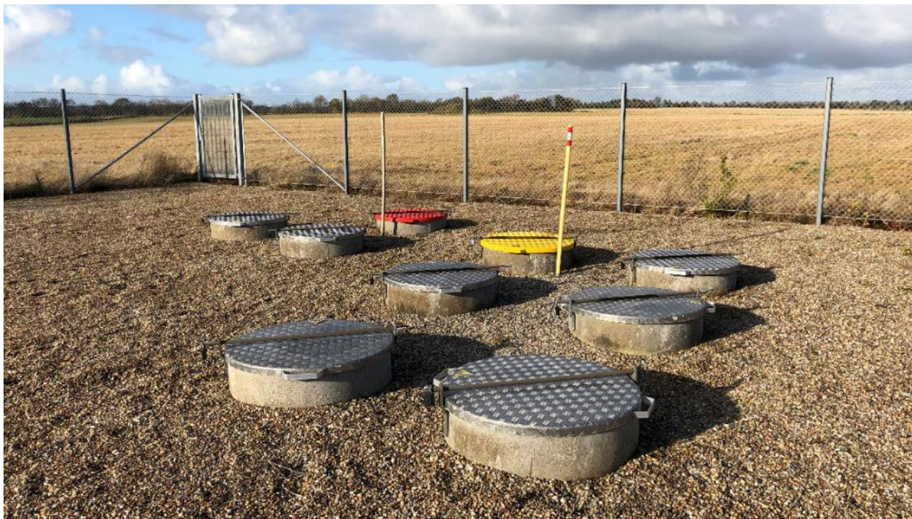
Figur 5-6 Eksempel på en LV-station. Beplantningen uden for hegnet er endnu ikke vokset op.
