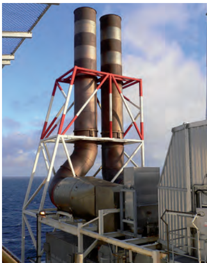
Afgangsrør fra gasturbine på Syd Arne platformen.
