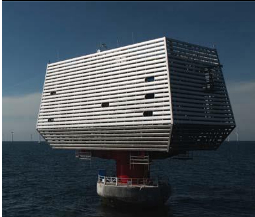
Figur 2.4. Eksempel på en off-shore transformerstation (Foto: EON, now RWE Renewables).
