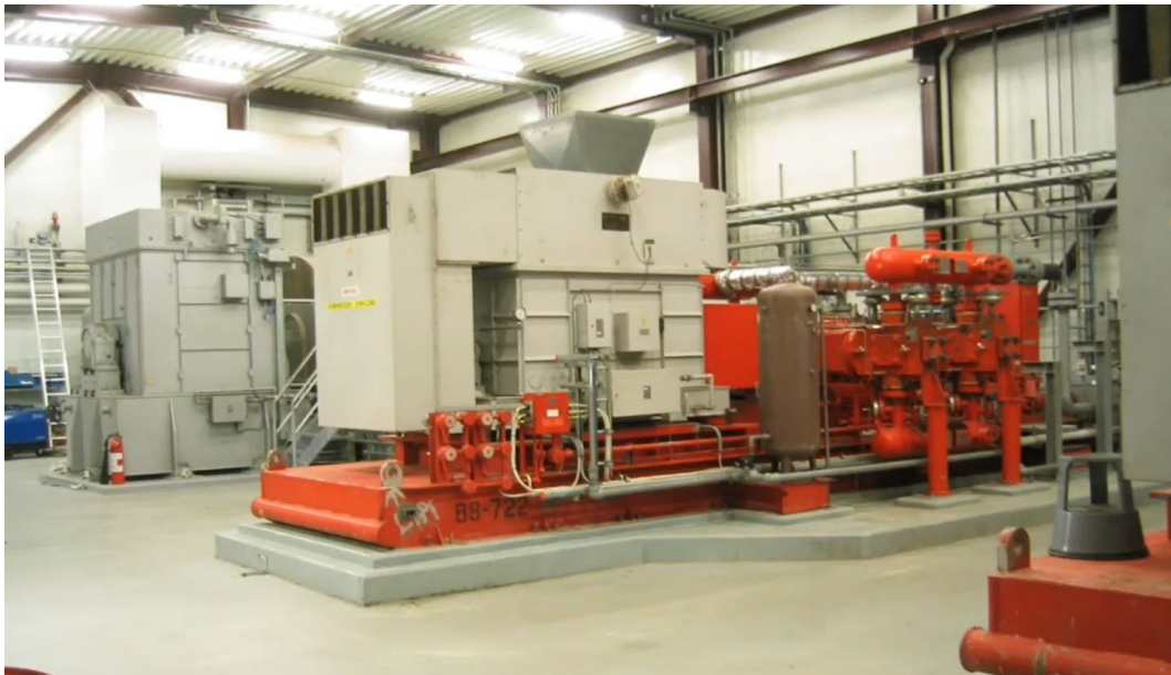
Abb. 3-4 Gebäude mit Verdichtern in Stenlille 16
