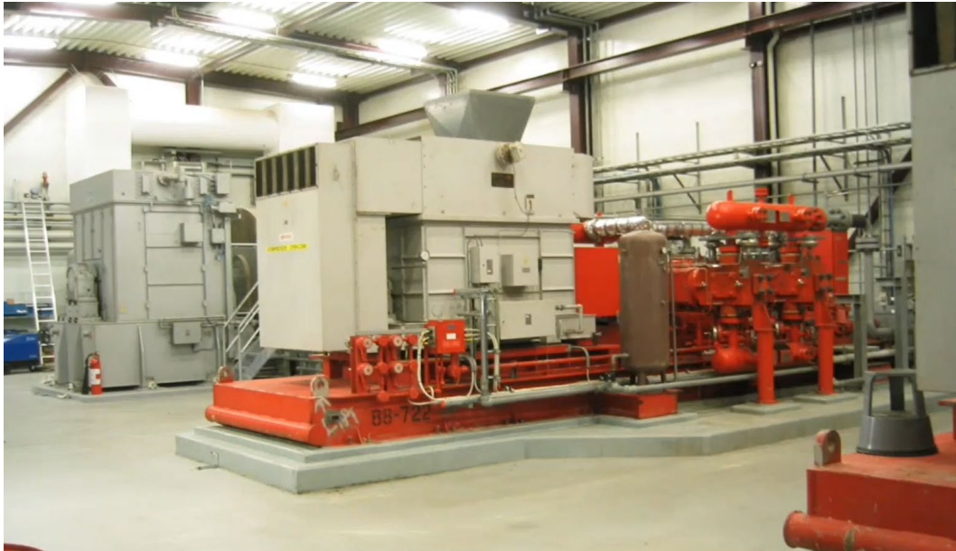
Figur 3-4 Bygning med kompressorer i Stenlille. 15
