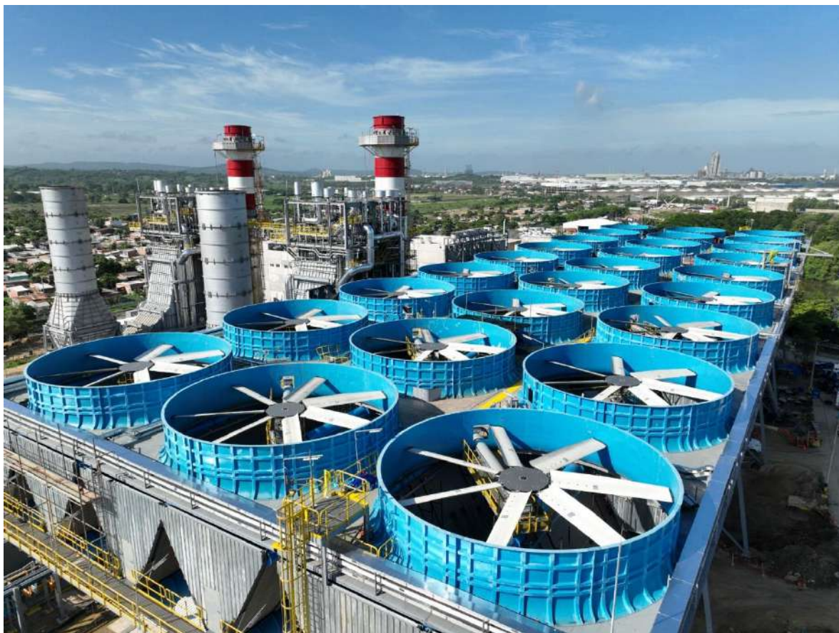
Figura 86. Central de Ciclo Combinado de Termocandelaria [15].
