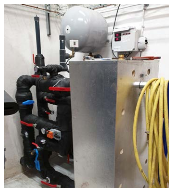
Varmeveksler til vandrør
