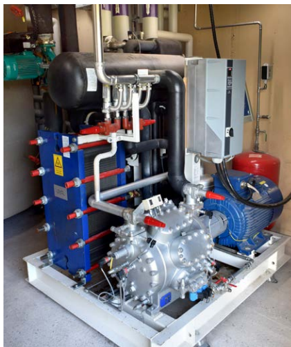
Stor varmepumpe, Permatopia
