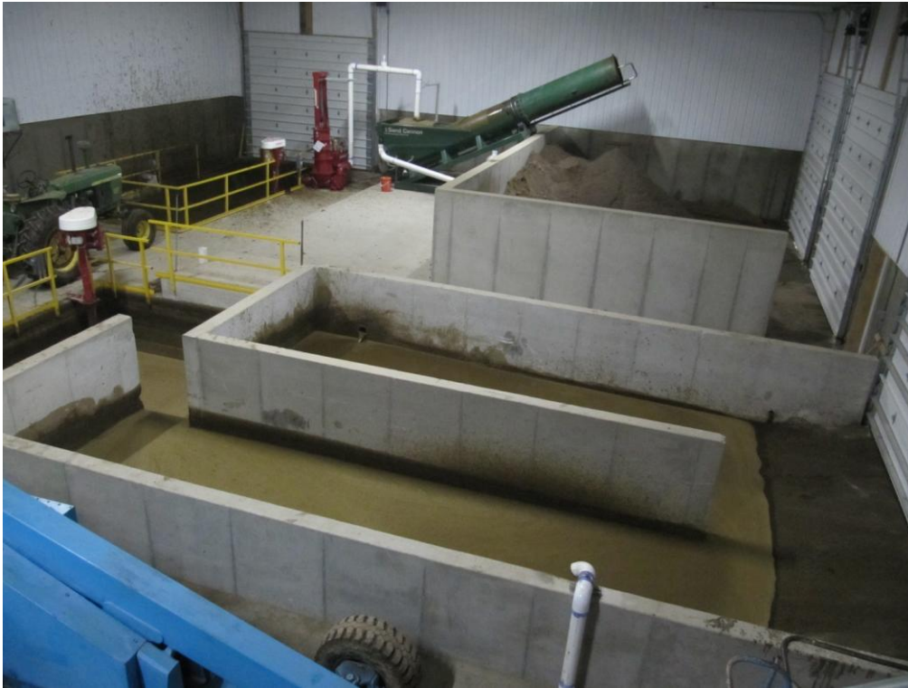
Billede 29: Teknikhal med system til frrensning af sand. Anlægget kan håndtere gylle fra ca. 1.500 køer
