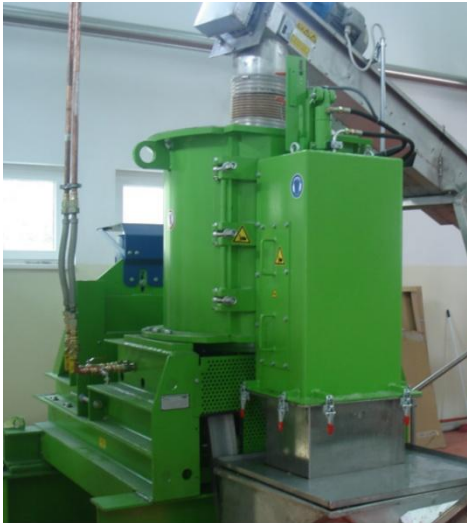
Billede 45: MeWa kædeknuser opstillet på anlæg
