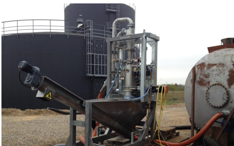
Billede 27: Opstilling af Cellwood cyclon med buffertank til rågylle
