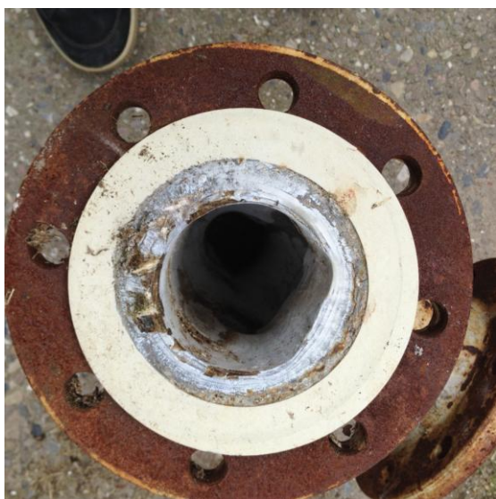
Billede 1: Pumperør med struvit belægninger
