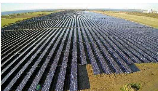
Figur 66 Solceller som barmark projekt optager arealer for omlægning til skovrejsning. Solceller på overdækning af Parkerings anlæg er et økonomisk konkurrence dygtigt alternativ og har klare positive effekter for biodiversitet når grønne arealer kan friholdes og benyttes til skovrejsning eller udlæg som naturareal i stedet.
