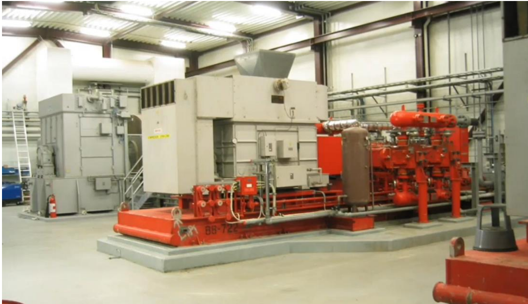
Figur 3-4 Bygning med kompressorer i Stenlille. 16
